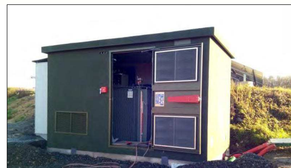
Figure 208: Photo d'un poste de transformation d'un projet en phase de construction (Source : IEL)
