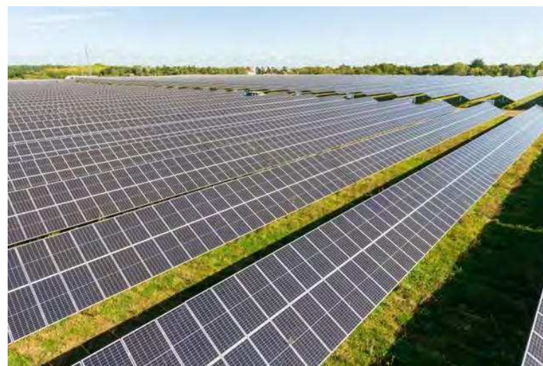
Figure 205 : Exemple illustrant l'espacement entre les rangées de panneaux photovoltaïques (FS Marc Energies, une réalisation IEL)
