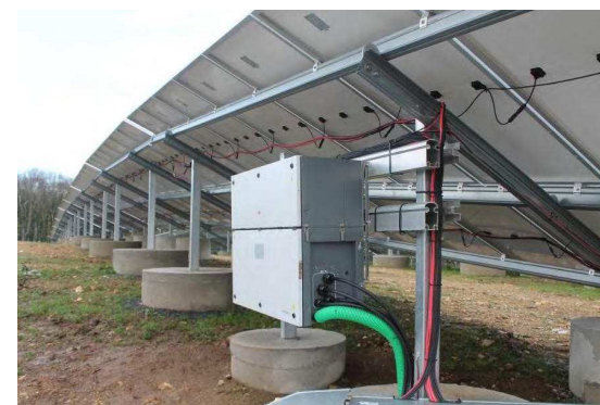
Figure 209 : Photo d'un onduleur d'un projet en phase de construction (FS du Cosquer, ancienne décharge, une réalisation IEL)
